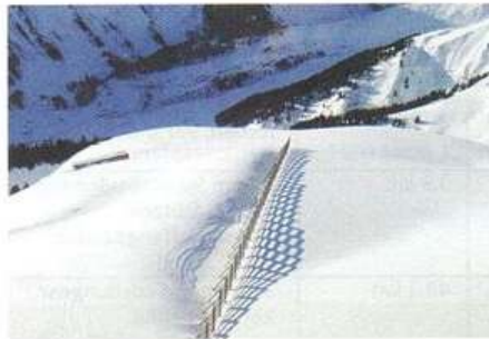
Lawinerverbauung L'Ondadusa, Schnee- verwehungswand, Tujetsch, 12. Januar 2012.
